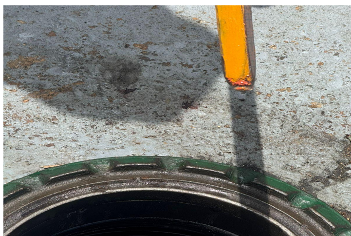
MEDICIÓN Y CORTE DE AGUA LIBRE EN LOS TANQUES DE ALMACENAMIENTO
