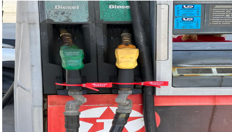
PICOS DISPENSADORES CLAUSURADO AL MOMENTO DE LA INSPECCIÓN.
